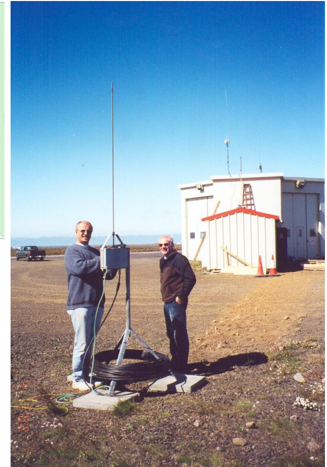
Starfsmenn UK Met Office setja upp mæli loftnet fyrir ATDnet eldingamælistöð á Keflavíkurflugvelli. Ljósm. ÞA 4. júlí 2002.
